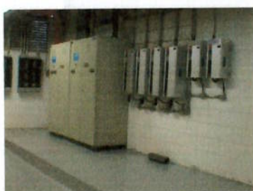
foto 17 – Quadro bombas e variadores
