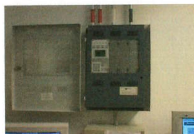
foto 10 – Painel de Incêndio
