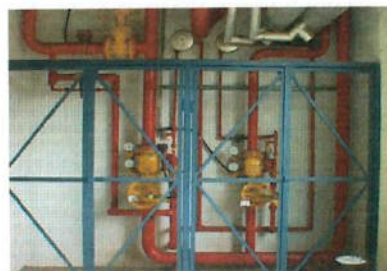
foto 8 – Sistema de incêndio
