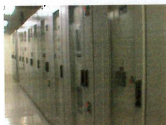
foto 13 – Painéis de energia
