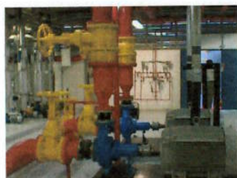
foto 19 – Bombas de incêndio
