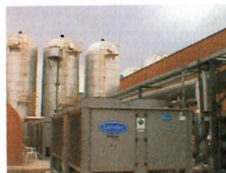
foto 20 – Chillers e Tanques água gelada
