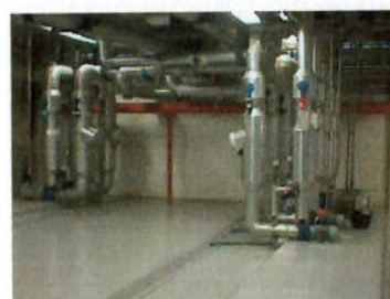
foto 18 – Bombas de água gelada
